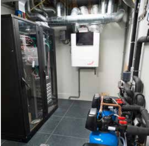
Alle besturingen komen samen in de centrale besturingskast in de technische ruimte.
